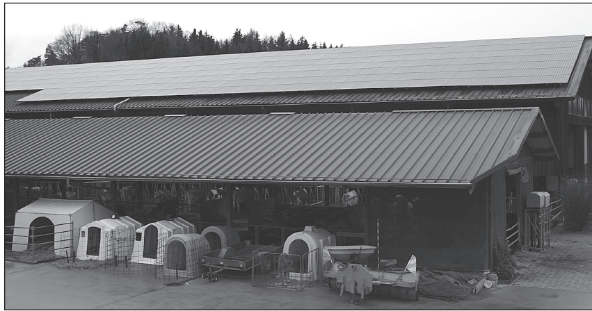
Das Solardach auf dem Brunnenhof ist flächenmässig eines der grössten in der Region Zentralschweiz. Bilder: Andreas Kaufmann
